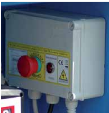
Quadro elettrico Electric panel
